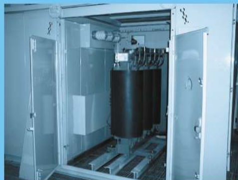
ПКТПВР с сухим трансформатором типа GDNN (Германия)
